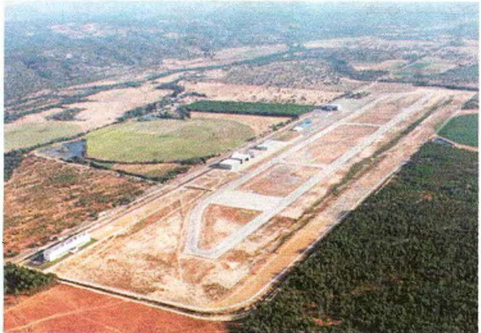
Obras de ampliação começam este ano e deverão estar concluídas no final de 2020
